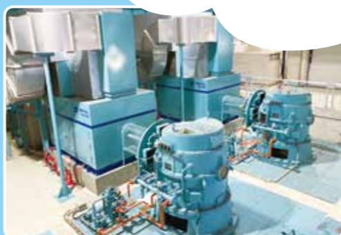
写真：西脇雨水ポンプ場内部(別府町西脇) 雨水揚水能力1,143 m 3 /分
