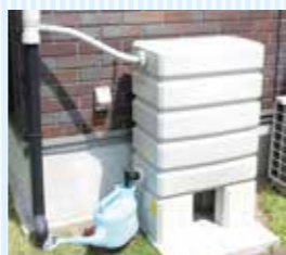
雨水貯留タンク
