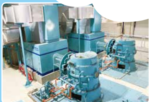
写真：西脇雨水ポンプ場内部(別府町西脇) 雨水揚水能力1,143 m 3 /分
