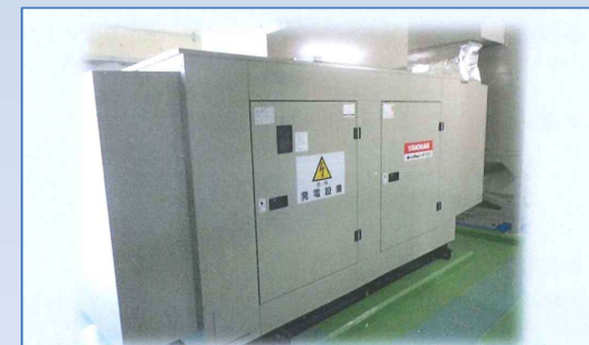
自家発電設備
