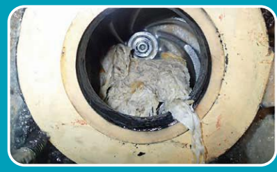
布等の異物が詰まった排水ポンプ。このままにしておくと汚水があふれてしまいます
