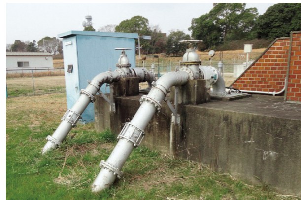
取水井（中西条浄水場）
