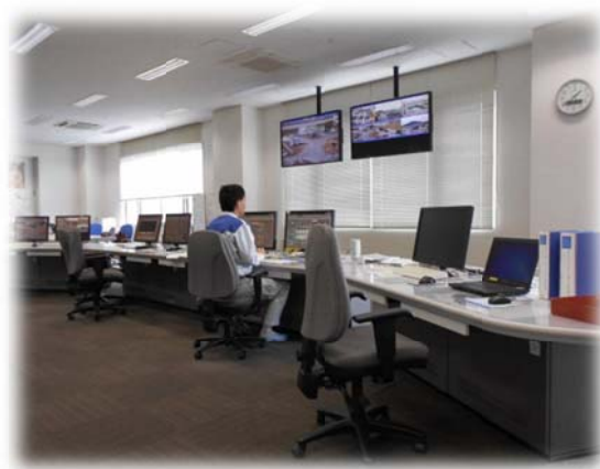
中西条浄水場中央監視設備
