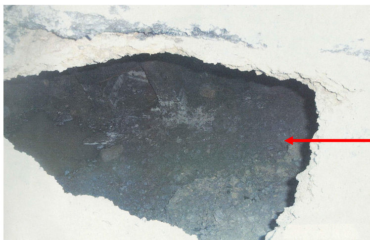
道路陥没 1.0m × 1.0m
