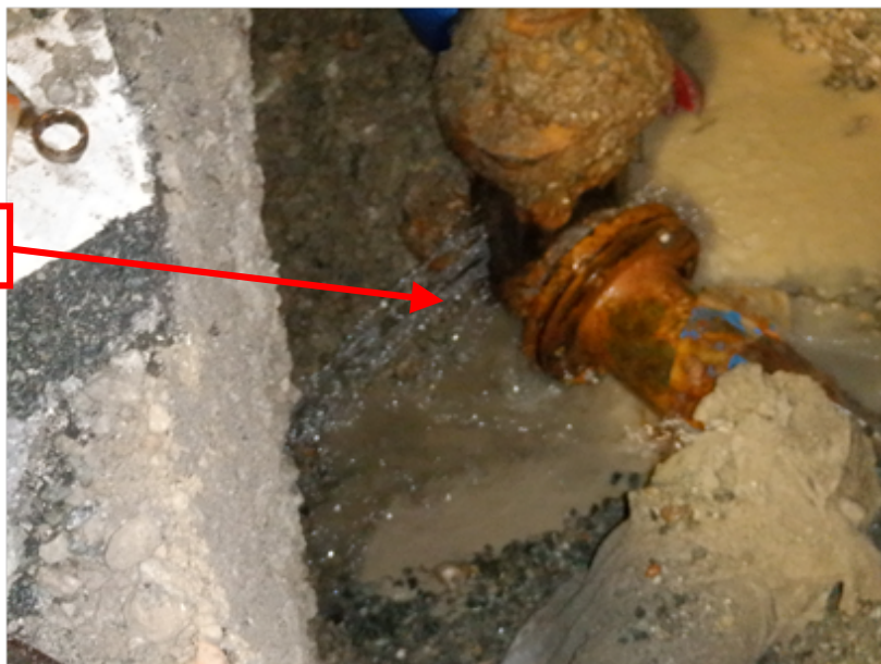
仕切弁からの漏水
