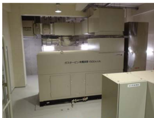
《自家発電設備》
