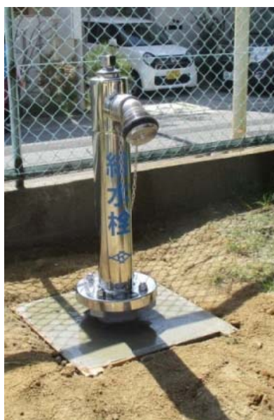
災害用応急給水栓 (氷丘南小学校)
