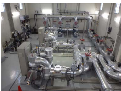
《紫外線処理設備》
