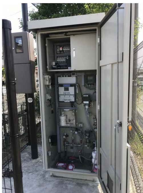
《給水モニター（八幡町）》
