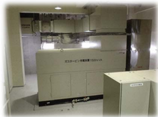
中西条浄水場自家発電設備
