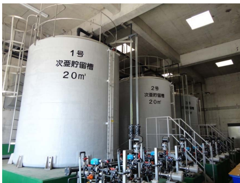
《中西条浄水場 次亜塩素酸ナトリウム貯留槽》
