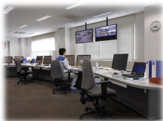
中西条浄水場中央監視設備
